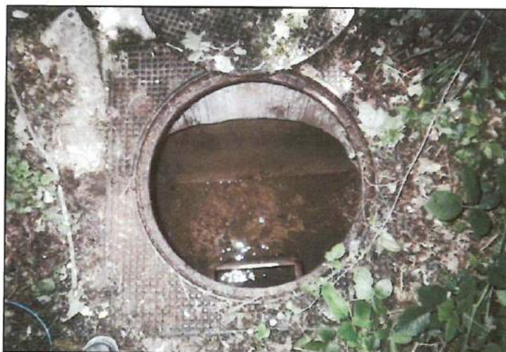
Photo 2 : Tampon de protection du captage
